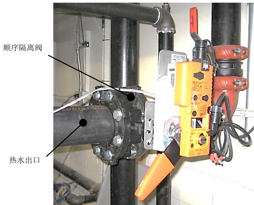
图 2-13：顺序隔离阀已经安装
